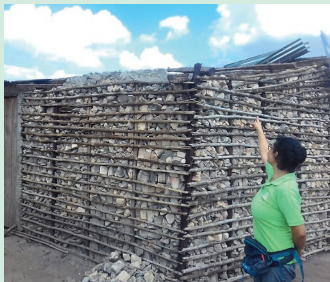
Wenigstens die Wände sind stehen geblieben.
