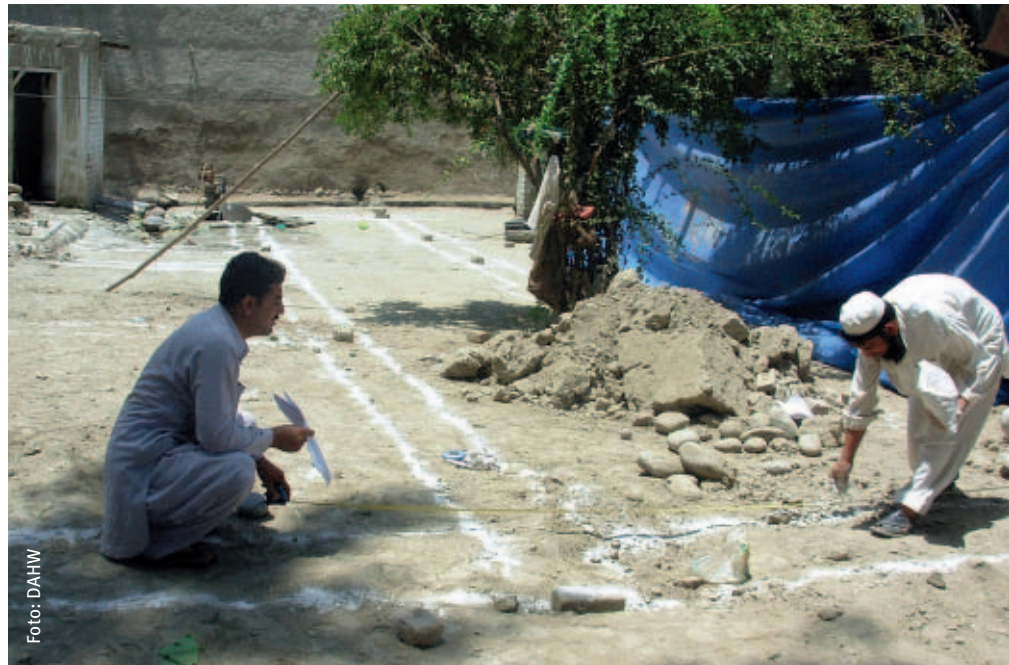
Stunde Null: In Pakistan wurden viele Häuser komplett zerstört und müssen neu gebaut werden.
