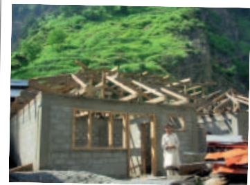
Nachrichten aus Pakistan: Fast ein Jahr nach der Flut sind schon viele Häuser neu gebaut, dieses im Swat-Tal wird bald fertig sein.
