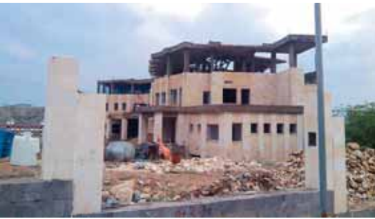
Zwei Raketentreffer haben das Dach zerstört. Das Hospital sollte eigentlich Anfang 2016 eröffnen. Wann die Menschen in Taiz und Umgebung nun diese wichtige Einrichtung nutzen können, ist derzeit unklar. Foto: Yasin al-Qubati
